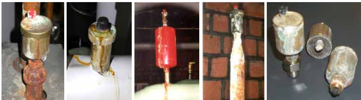
Eksempler på lufteventiler av lav kvalitet som raskt begynner å lekke på grunn av dårlig oppbygning
