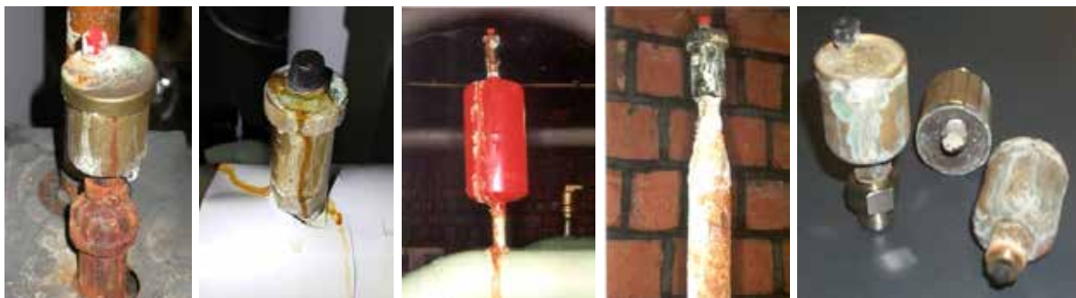
Exempel på luftavskiljare som börjar läcka pga felaktig konstruktion
